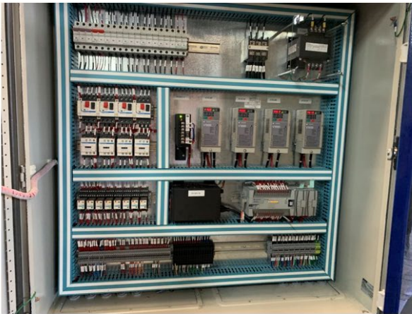
Figura 1. Módulo de control del sistema de bandas.
