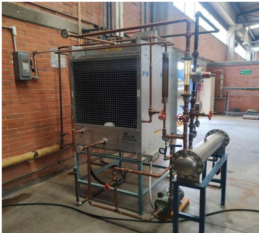
Figura 1. Torre de enfriamiento, Nave 1000 Ingeniería Química.
