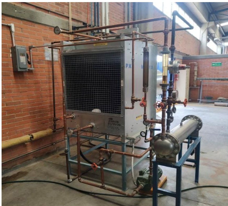
Figura 1. Torre de enfriamiento, Nave 1000 Ingeniería Química.
